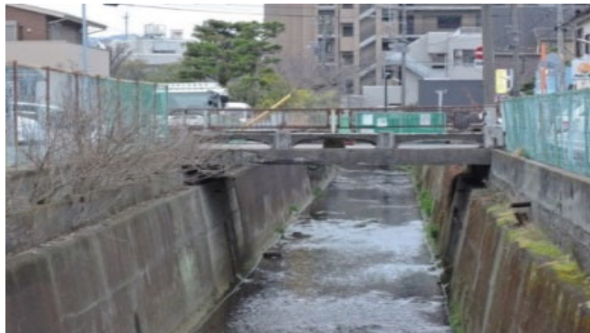
老朽化した橋梁（補強前）
