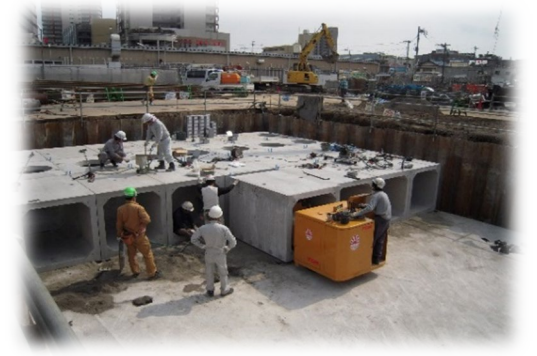
BOX型雨水貯溜槽への適用例 内幅1200×内高1200mm (ボックスどうしは耐震接続「TB(タッチボンド)工法」)
