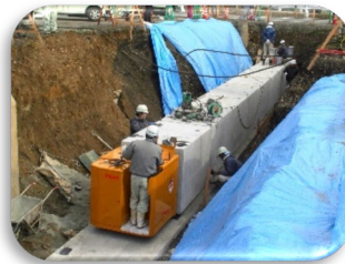
据え付け状況
