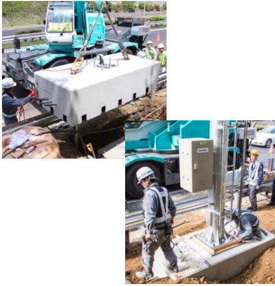
CCTVカメラ支柱ベース
